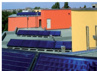
Panneaux d'absorption sur le toit
